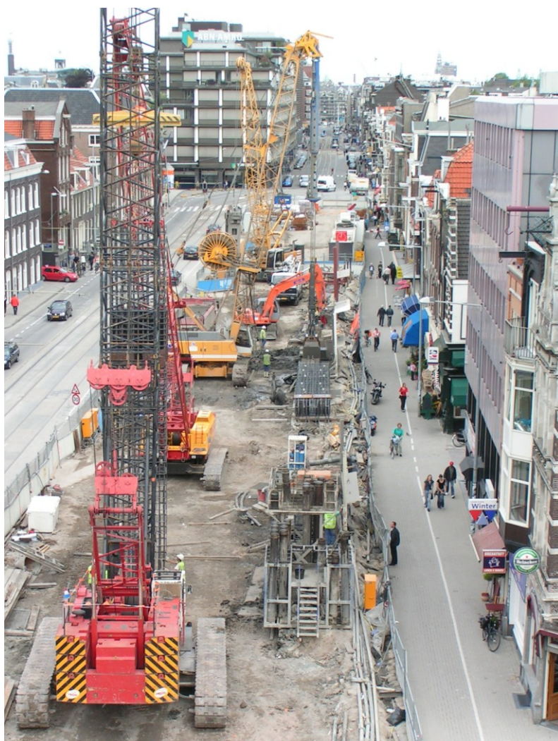
Fig 2: Le public se trouve souvent sans aucune protection à l'extérieur des palissades des chantiers.
